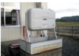
防油堤が設置されているホームタンク
