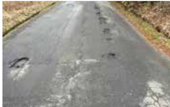
冬季間の凍結による陥没ひび割れ
