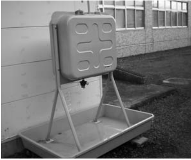
事故防止のため防油堤を設置しましょう
