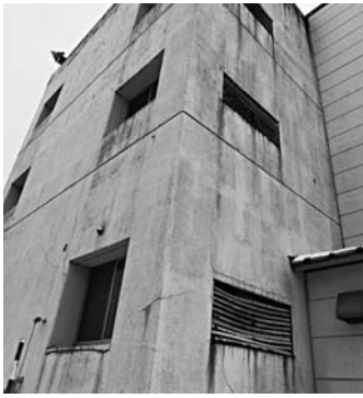
金物は腐食し、外壁には無数の亀裂が走る老朽化の進んだ松尾庁舎
