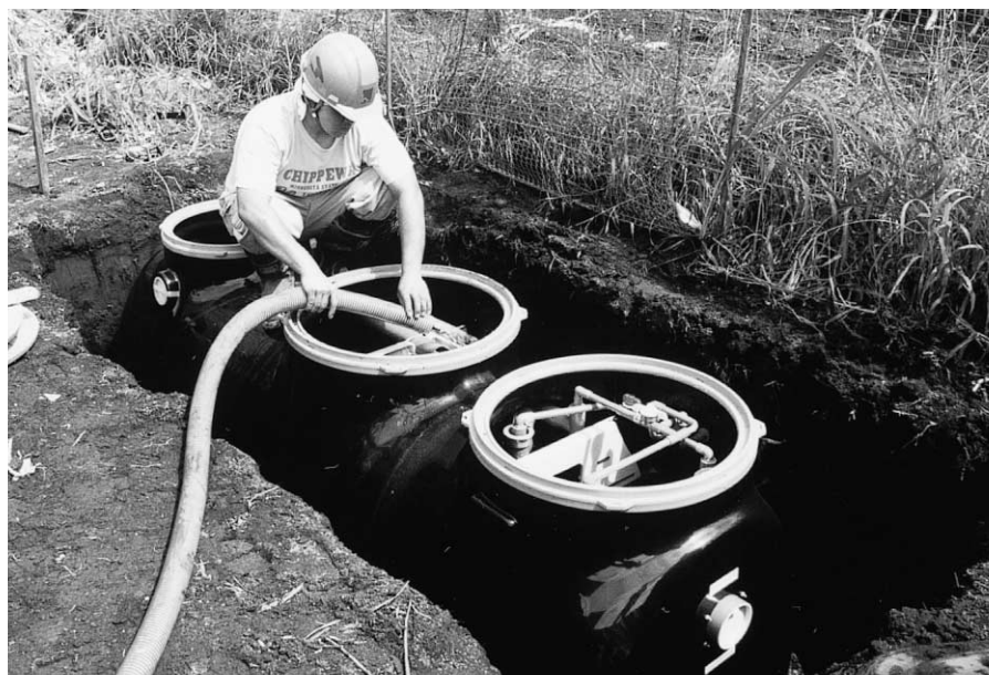
個別浄化槽の設置について、詳しくは市役所上下水道部にお問い合わせください
