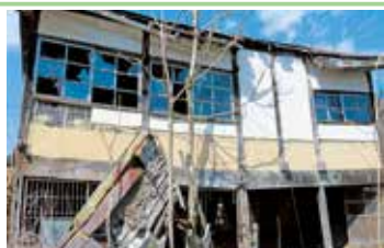
長年経過した空き家
