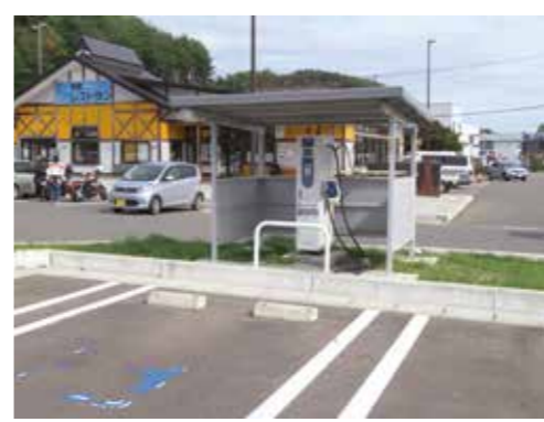
「道の駅にしね」のEV充電施設
