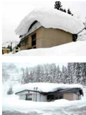
<危険な空き家の例>
