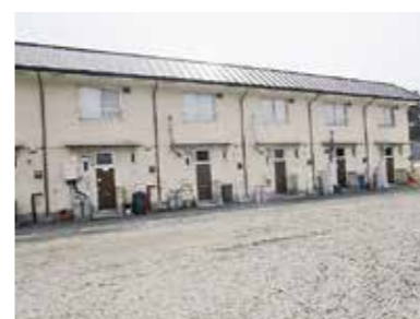
隙間風や雪が入る矢神住宅
