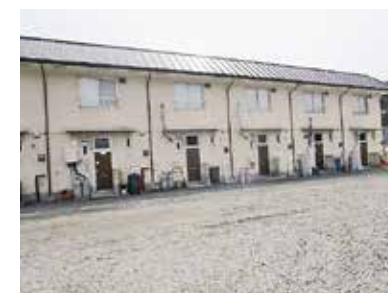
隙間風や雪が入る矢神住宅
