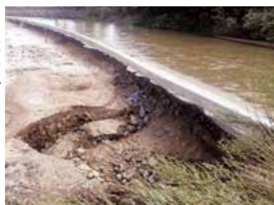
復旧しても被災した松川河岸
