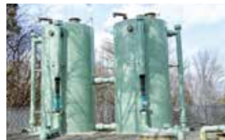
展望台貯湯槽
