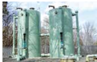
展望台貯湯槽
