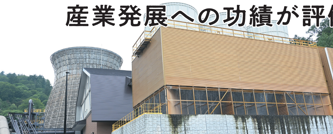
施設更新された新冷却塔(手前)と、旧冷却塔(写真奥の砂時計型の構築物=令和10年に撤去を予定)
