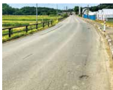
劣化で消失したセンターライン
