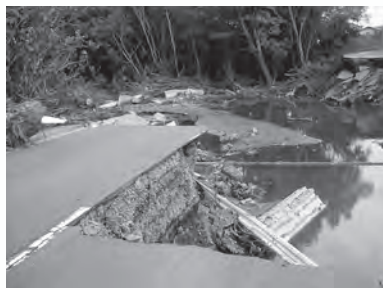
台風18号によって寸断された 市道山後線(西根地区・大更)
