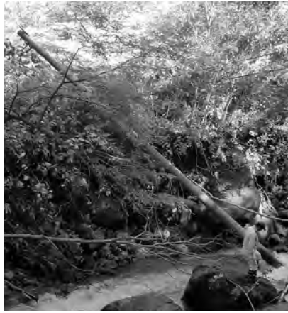
松尾地区・焼切沢の引湯管 破損により温泉供給が中断
