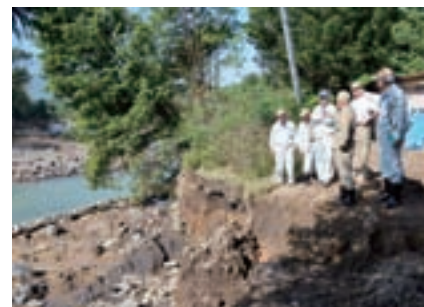
松川の濁流で破壊された松川橋上流の護岸
