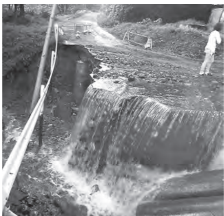
豪雨で崩落した道路(兄川)
