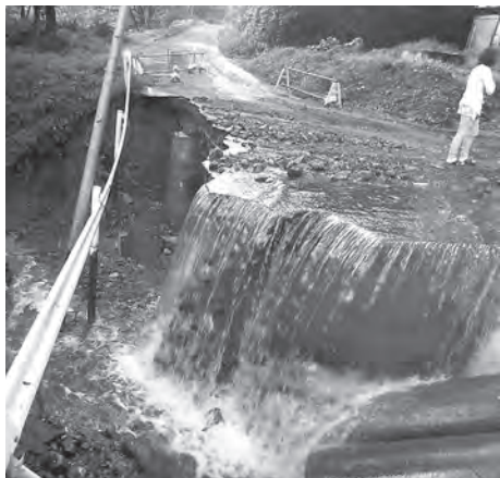
豪雨で崩落した道路(兄川)
