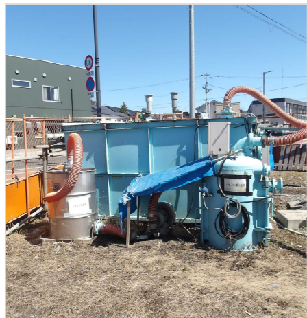
揚水ばっ気処理装置
