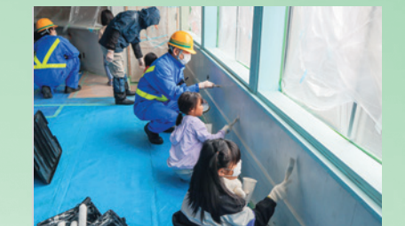
駅の歴史を振り返る展示会に向け地域住民が駅舎の改装や壁面塗装を行った(10月21日、荒屋新町駅)
