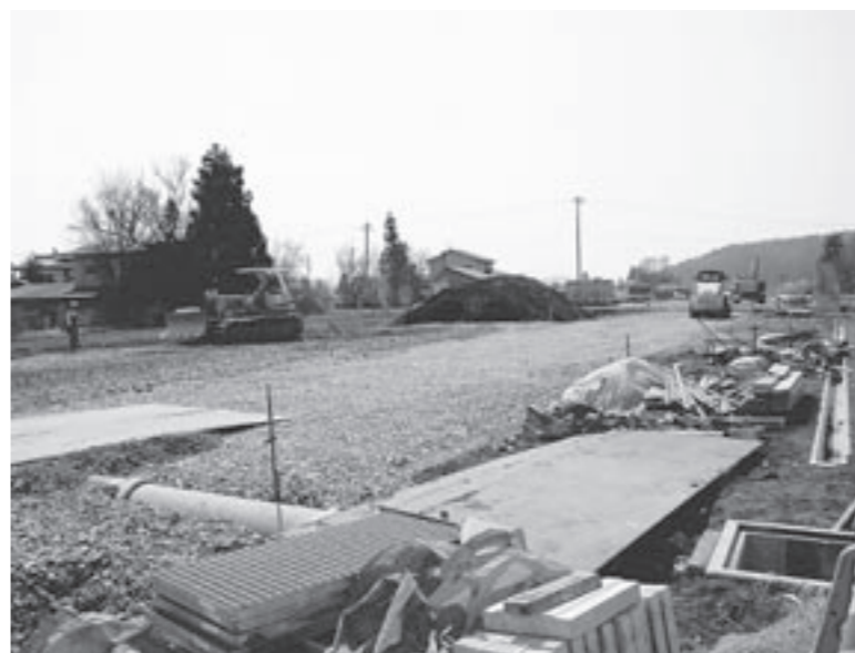
建設工事が進む西根バイパス（市総合運動公園入口付近）。市では県から用地取得などの業務を受託し、早期完成に向け取り組みます
