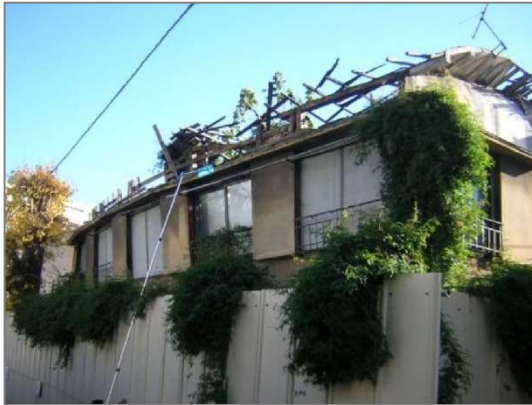
資料3. 屋根及び2階の床がなく立木等が繁茂し、景観を損なっている状態
