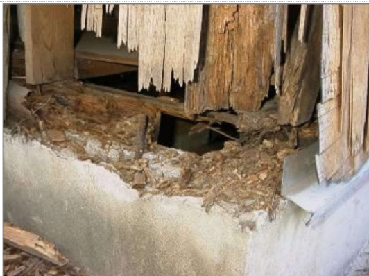
資料4. しろありの害が発生し、欠損している状態
