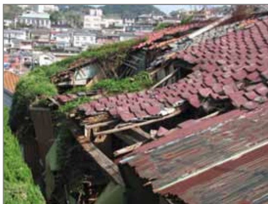
資料 2. 屋根の一部を備えないことにより風雨、動物、害虫等が容易に侵入する状態
