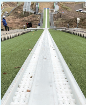
競技環境の安定のため、助走路の下を通る冷媒管で、助走路の氷を冷却
