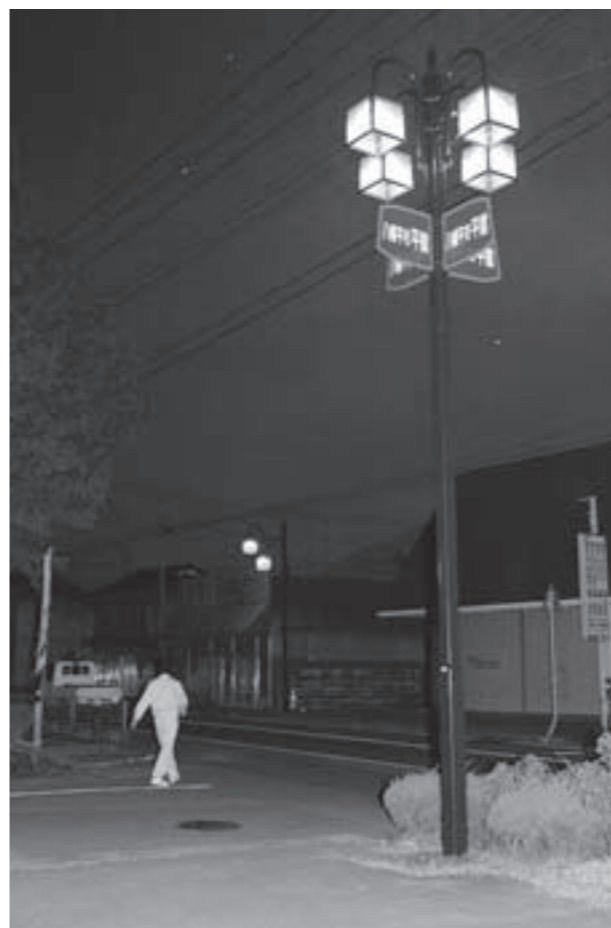
市内の街路灯については、照明設備の設置者が維持管理し、経費を負担する原則になっています
