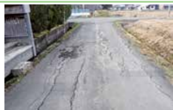
冬季の凍結による陥没ひび割れ
