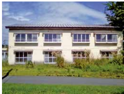
老朽化が進む保土沢の教員住宅
